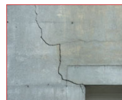
Enduit ciment sur une maçonnerie ancienne : fissurations
